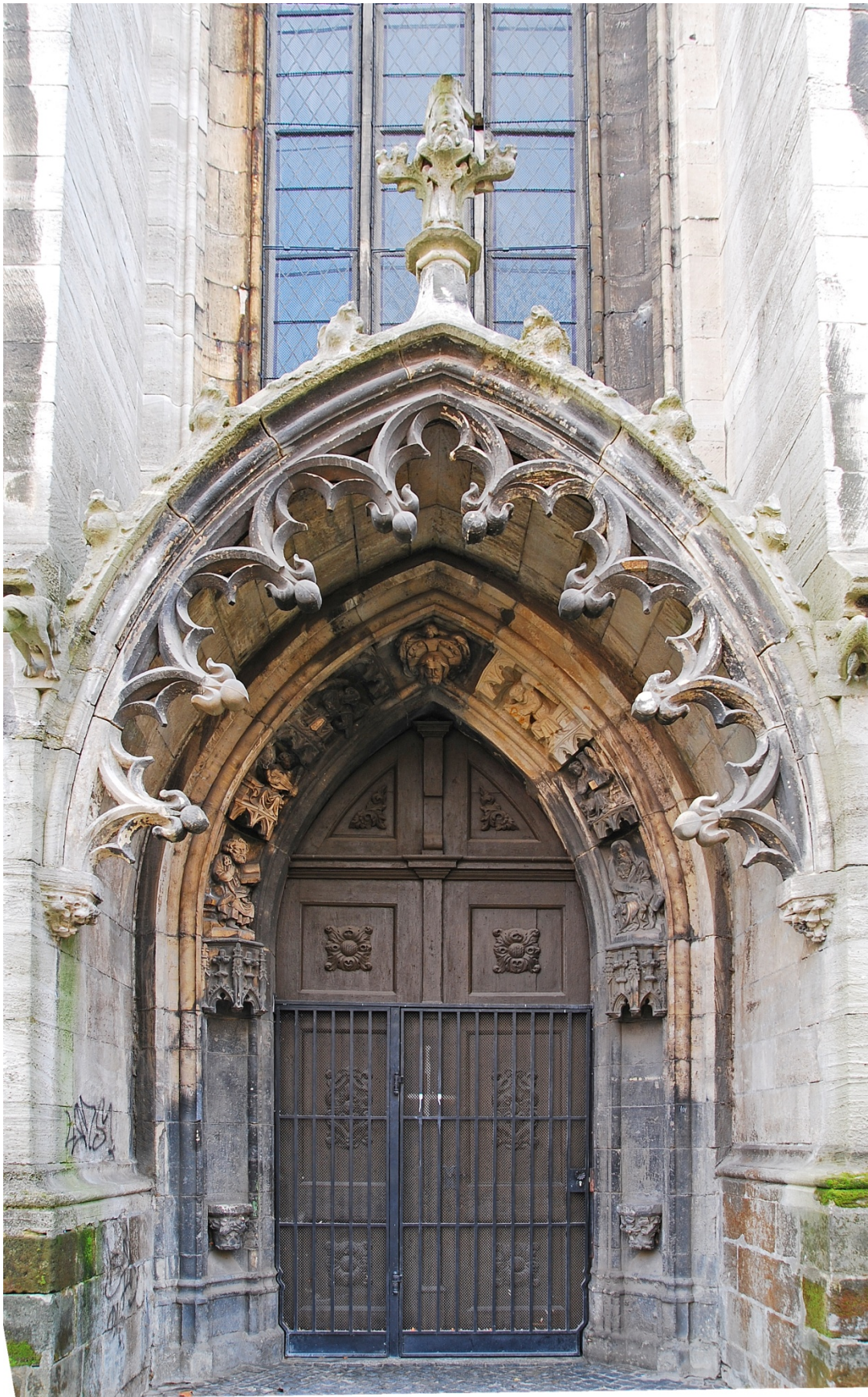
Bild III.35: Halle/Saale, Moritzkirche, östliches Nordportal im Langhaus. Spitzbogenportal mit Überdachung durch einen Kielbogen. Keine Profilüberschneidungen, um 1420.
