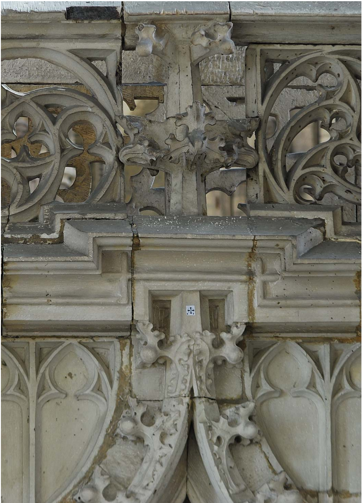
Bild II.9: Krabben und Kreuzblumen des Kielbogens über dem nördlichen Durchgang. Die Krabbenformen des nördlichen und südlichen Kielbogenschenkel sind gleich. Die beiden Kreuzblumen haben davon abweichende Muster.
