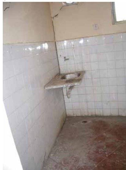
Foto 5-51: Die ehemals geplanten Küchen in den Bungalows wurden nicht eingebaut, der Raum ist in einem ungepflegten Zustand
