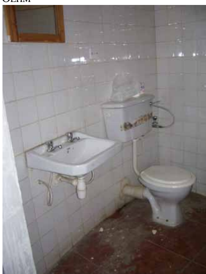
Foto 5-49: Die Toiletten in den Touristenbungalows sind in einem desolaten Zustand
