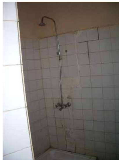
Foto 5-50: Die Sanitäranlagen sind wenig gepflegt und schon nach nur zwei Jahren wieder baufällig
