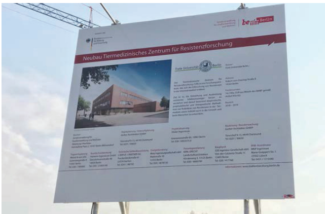
Bilder 4 & 5: Errichtung der Baustelle im März 2018 mit dem ersten Bagger und dem Bauschild
