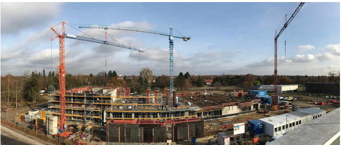
Bild 8: Die Baustelle Anfang November 2018 mit Beginn der Arbeiten im 1.OG und am Außenlager.
