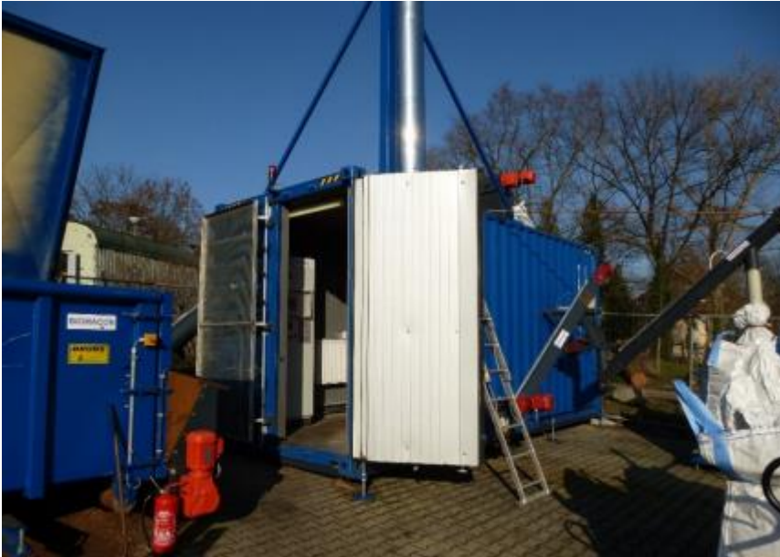
Abb. 2.9: Karbonisierungsanlage der Firma BioMaCon im Botanischen Garten Berlin (Bildquelle: Robert Wagner)
