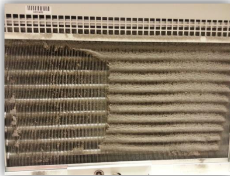
Abbildung 179: Verschmutzte Kühlrippen reduzieren die Kühlleistung erheblich
