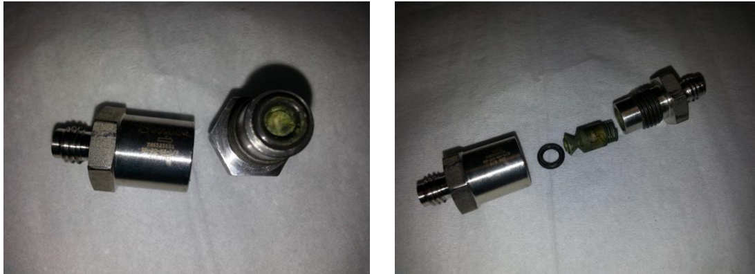
Abbildung 160: Verstopftes Rückschlagventil im geöffneten Zustand (li.) und re. komplett demontiert
