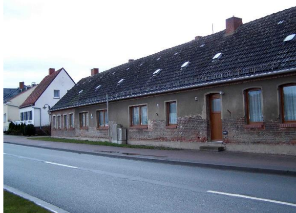
Bild 39: Fassadenschäden Bettina Wenzel, Katastrophenforschungsstelle
