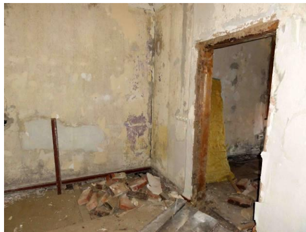
Bild 28: Wasserschäden (Bettina Wenzel, Katastrophenforschungsstelle)
