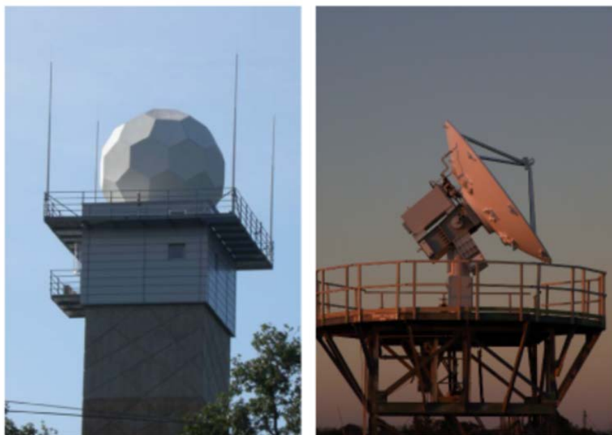
Abbildung 3: Links: Wetterradarsystem Offenthal auf seinem circa 45 Meter hohen Betonturm. Das eigentliche Radarsystem wird durch das Radom vor Witterungseinflüssen geschützt. Weiterhin sind die vier Blitzschutzstangen zu sehen. Rechts: Ein Wetterradarsystem ohne schützende Radarkuppel. Die in Azimut und Elevation bewegliche Antenne ist, zusammen mit den notwendigen Gegengewichten, auf einem Standfuß montiert. Hinter dem Radarreflektor ist der Empfänger angebracht.
