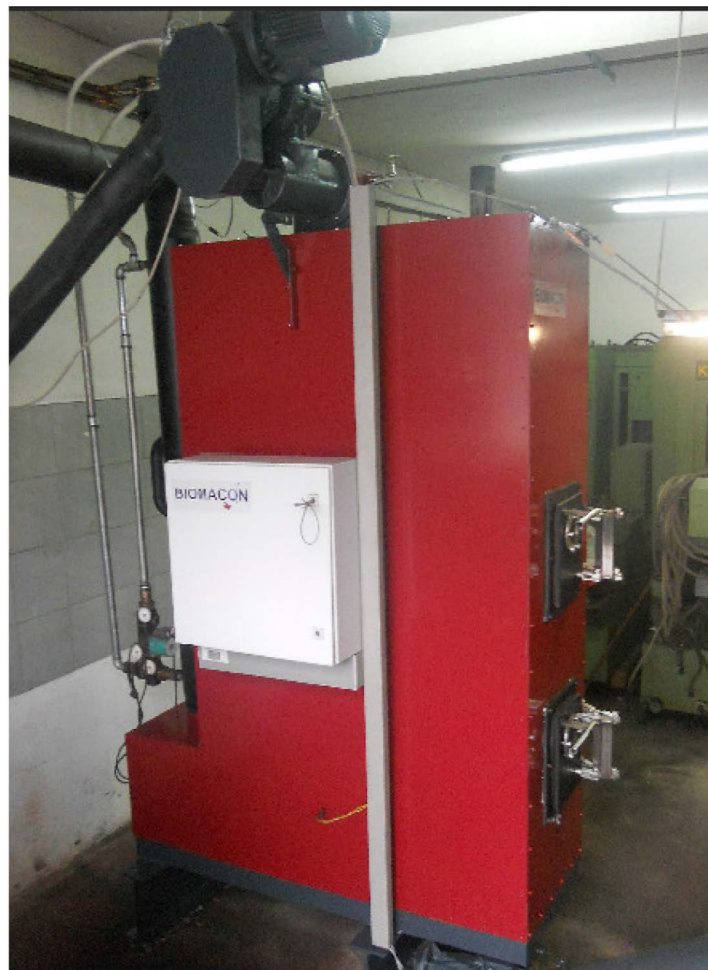
Abbildung 3.3: Gesamtansicht der BioMaCon-Anlage zum Zeitpunkt der ingenieurtechnischen Vorplanung (Quelle: BioMaCon)
