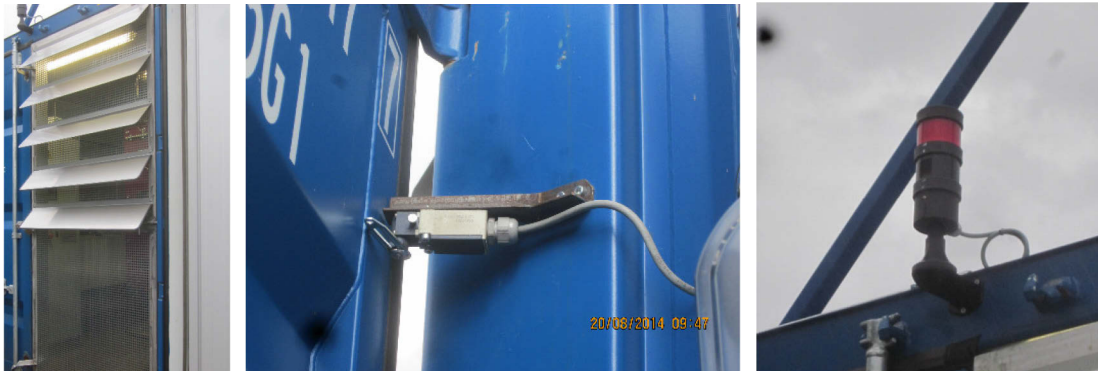
Abbildung 3.8: Installation einer Sicherheitstür (Lochblett mit Regenabweiser, links), eines Sicherheitsschalters an der Flügeltür (Mitte) sowie eines optischen und akustischen Warnsignals (rechts)
