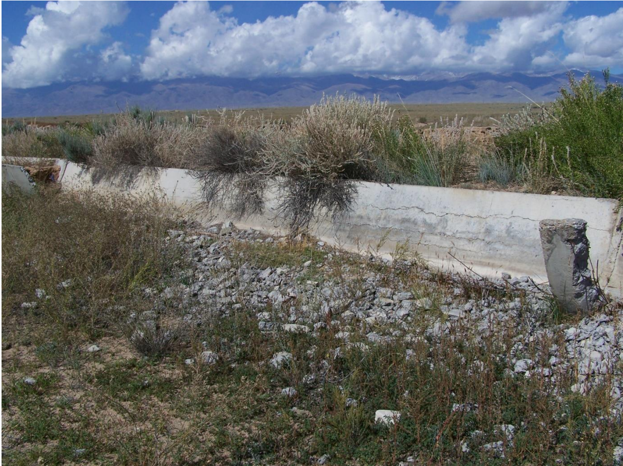
Abbildung 49: Zerstörter Bewässerungskanal in Toru Aigyr Bewässerungskanäle aus Beton wurden zum Teil zerstört, um die Armierungen als Altmetall zu verkaufen. Die Feldfluren in diesem Bereich sind ohne Bewässerung nicht nutzbar und liegen brach. Foto: BW, 24.9.09
