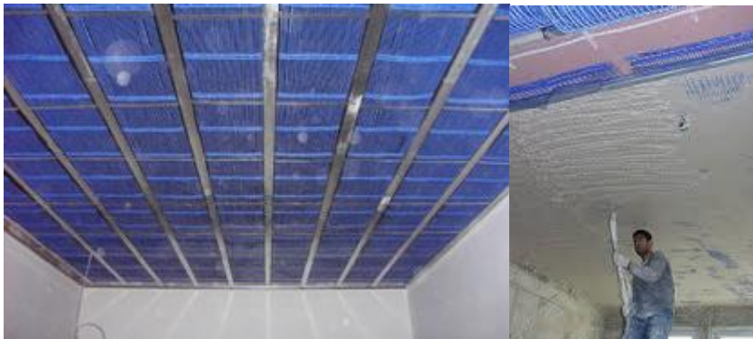
Abbildung 10: Aufbau der konvektionsfreien Klimazimmer, deutlich zu sehen sind die hinter Spritzputz befindlichen Tube mats.
