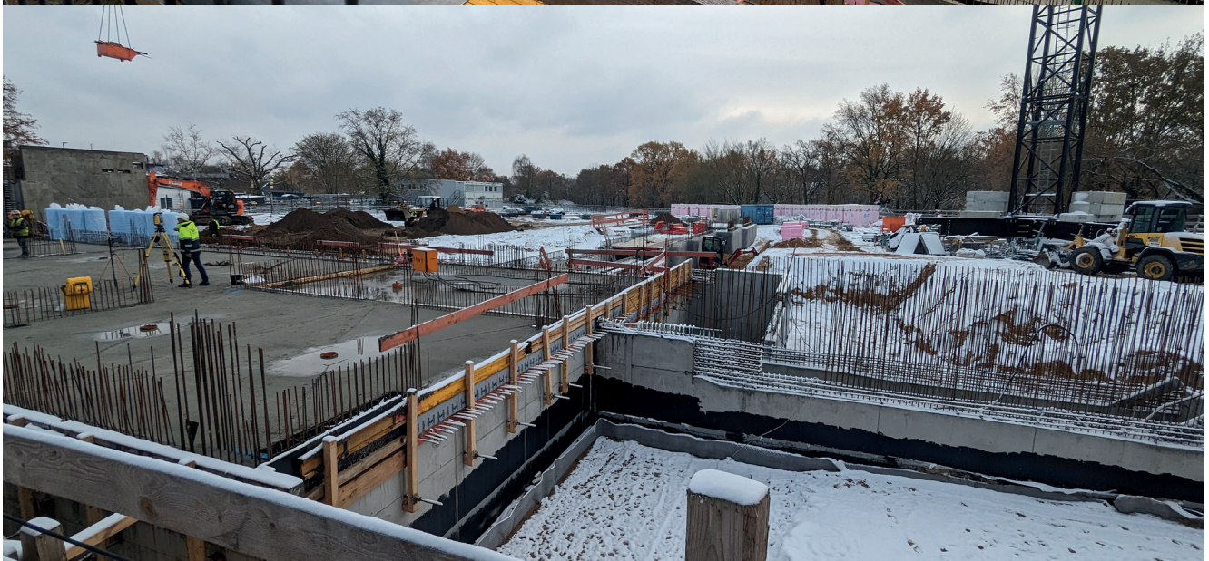
Bild 2, 3 und 4: Fortschritt auf der Baustelle des neuen Gebäudes für die Lebensmittelsicherheit und -hygiene
