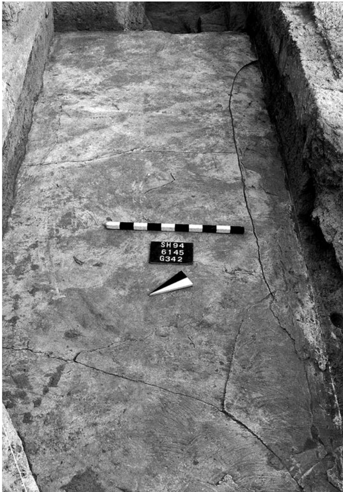
Abb. 300: Der in Korridor ZX/RX verlegte, 4 bis 5 cm starke Kalk-estrich blieb bis auf wenige Bruchstellen erhalten. Die quer verlaufenden Risse entsprechen weitgehend den Stößen der einzelnen Verlegeabschnitte.
