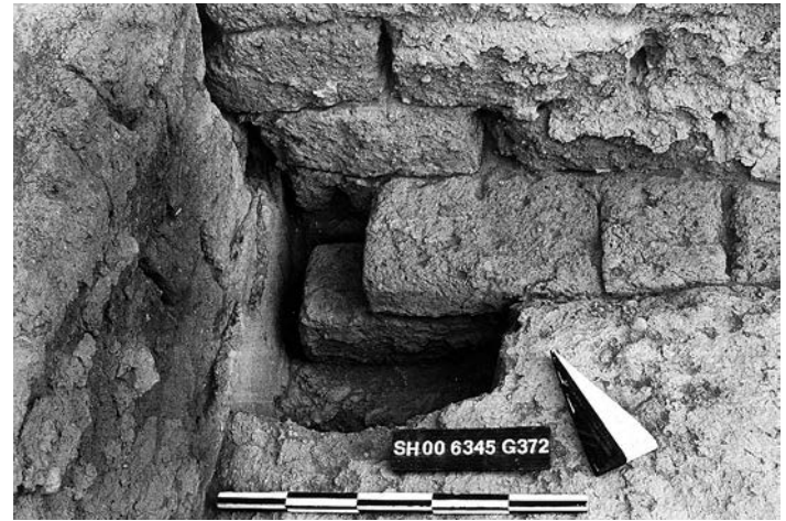
Abb. 275: Baunaht zwischen ZM 234 und ZM 228. Der Verputz der älteren ZM 228 zieht \frac{1}{2} LZ tief in die Fuge bis zur ursprünglichen Raumecke.
