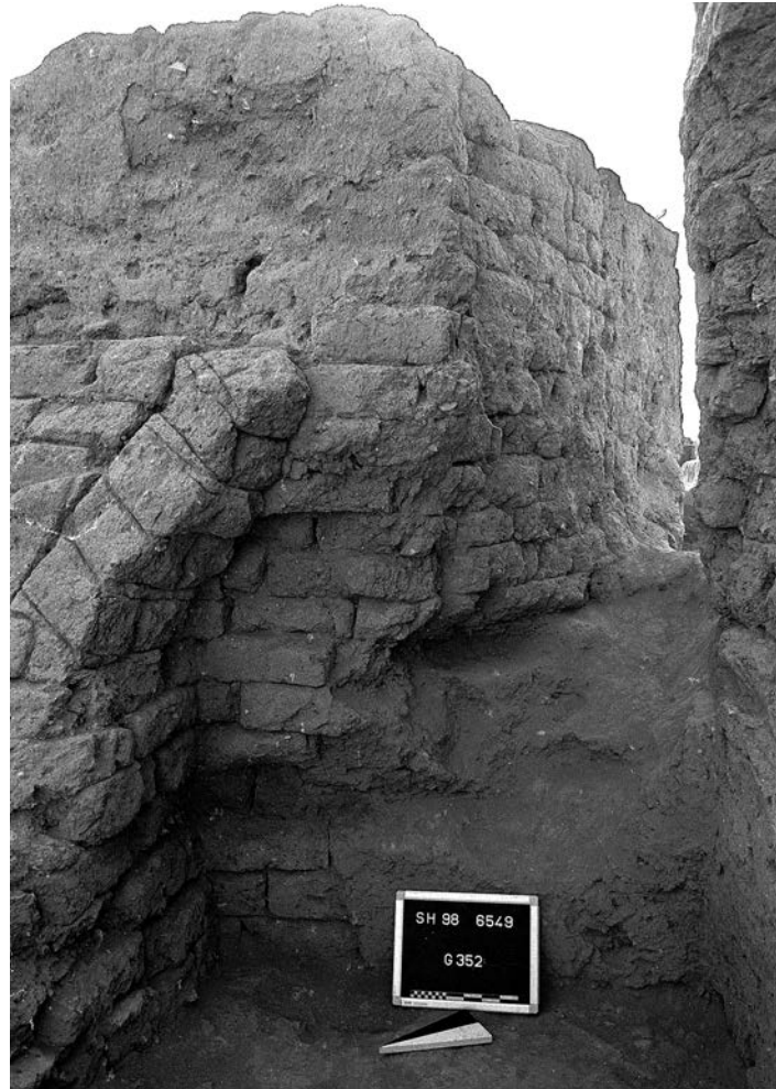
Abb. 86: Erosionsschaden in der Südostecke des Raumes PY gefüllt mit EE 00-03-e01.
