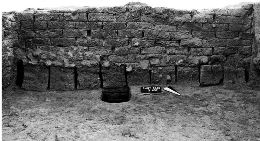
Abb. 272: Reparatur der durch Feuchtigkeit geschädigten Sockelzone an ZM 227 in Raum FW mit hochkant gestellten Lehmziegeln.
