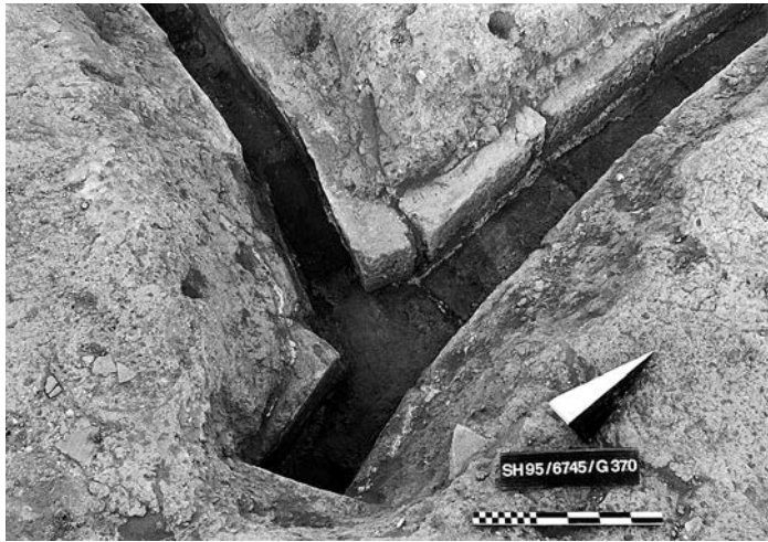
Abb. 319: Zusammenfluss der aus den Höfen LY und EW kommenden, aus gebrannten Lehmziegeln errichteten Entwässerungsrinnen in Raum OW.
