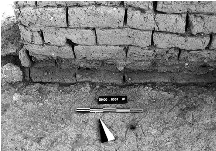
Abb. 277: Schädigung des Mauerfußes durch aufsteigende Bodenfeuchtigkeit. Die Ziegeloberflächen lösen sich infolge des ständigen Wechsels von Durchfeuchtung und Trocknung auf und sanden ab.
