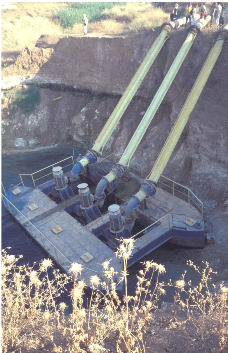
Abb. 13:05 Ein Quelltopf der H̄abürquelle mit installiertem Pumpboot im Jahr 2004 (Photo: H. Kühne)
