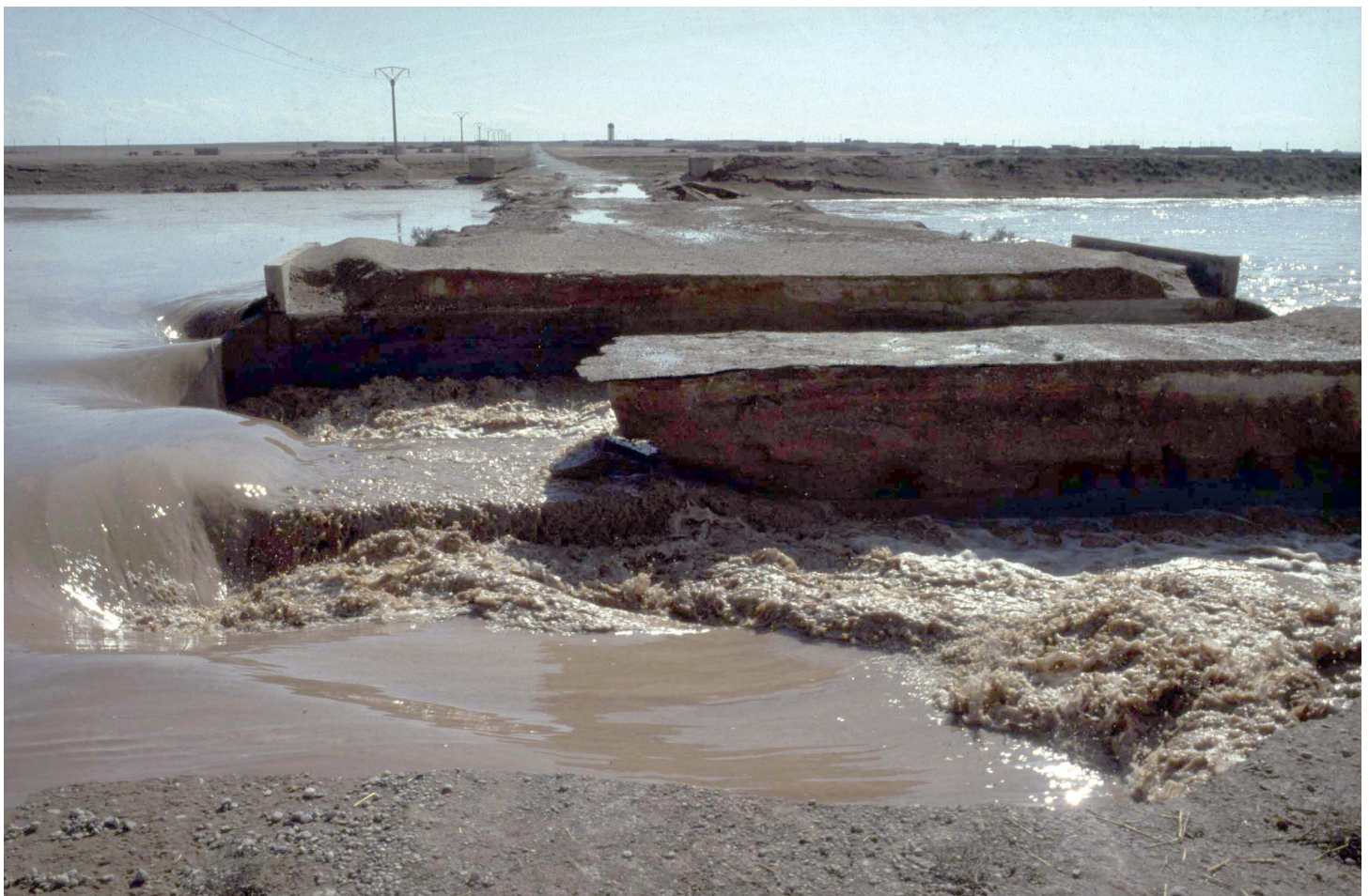
Abb. 13:10b Die Brücke und die Strasse im Dorf Gharibe kurz nach dem Wasserdurchbruch (Photo: H. Kühne 1987)
