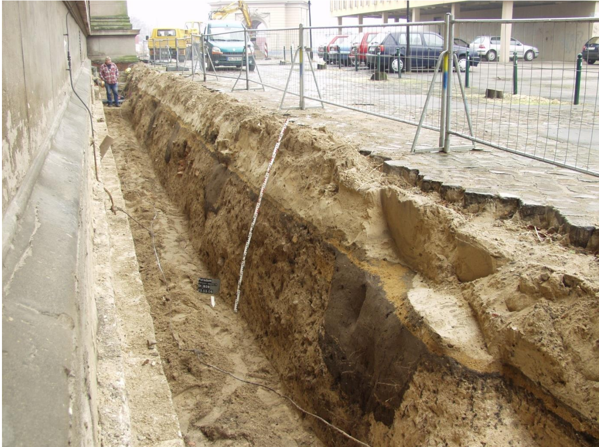
a) Aufgrabung für die Fundamentsanierung an der Nikolaikirche. Es waren um die Kirche herum an keiner Stelle ältere Fundamente auszumachen.
