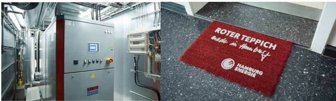
Abbildung 44: BHKW (links) und Fußmatte für Abnehmer des Quartiersstroms (rechts) – Quelle: KfW 2016
