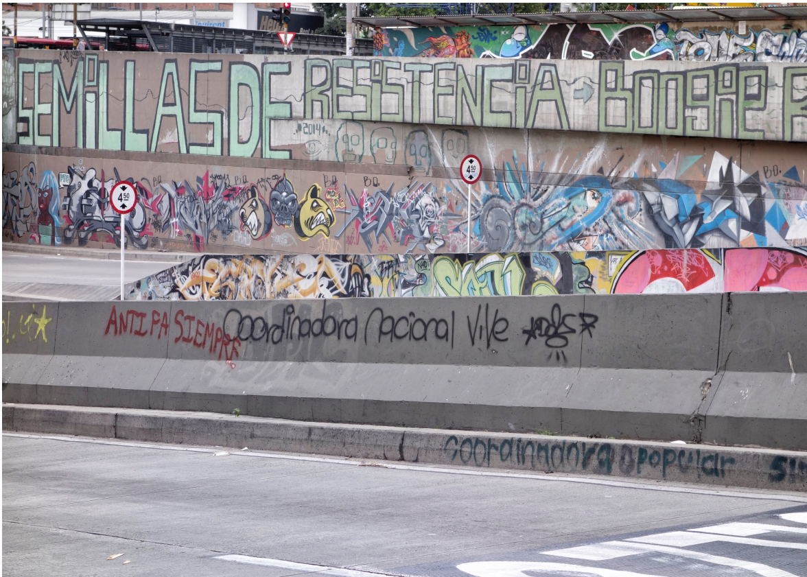
Graffiti jeglicher Couleur an den „fachadas falsas“ entlang der Transmilenio-Route in der Calle 26
