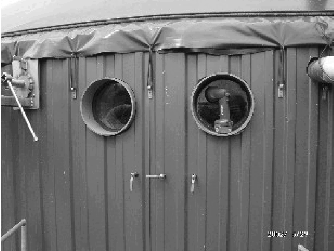
Abbildung 6: Anlage D, Fermenter mit Schauglas (Foto: Klages, KTBL, 2003)
